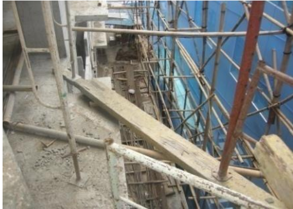
Gambar 5.9 Penggunaan scaffolding yang tidak aman (Foto 8)
