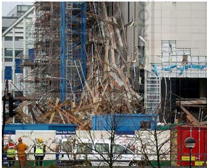
Gambar 1.1 Contoh kecelakaan scaffolding
