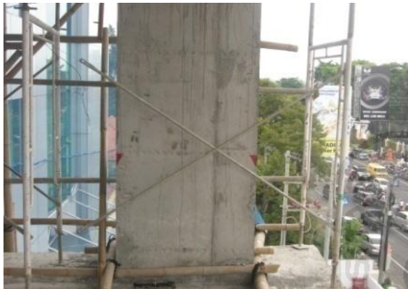
Gambar 5.14 Penggunaan scaffolding yang tidak aman (Foto 13)
