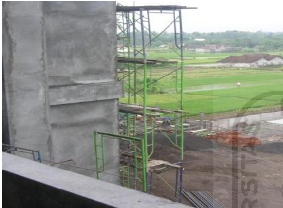
Gambar 5.16 Penggunaan scaffolding yang tidak aman (Foto 15)
