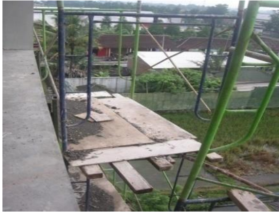
Gambar 5.19 Penggunaan scaffolding yang tidak aman (Foto 18)
