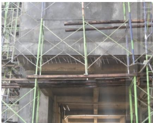
Gambar 5.5 Penggunaan scaffolding yang tidak aman (Foto 4)
