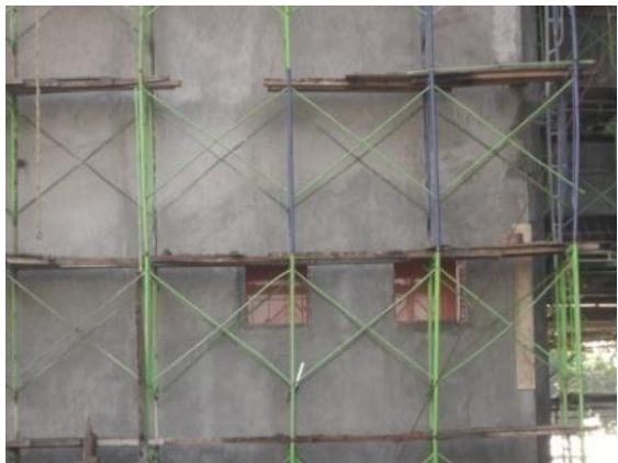
Gambar 5.26 Penggunaan scaffolding yang tidak aman (Foto 25)
