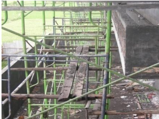
Gambar 5.27 Penggunaan scaffolding yang tidak aman (Foto 26)
