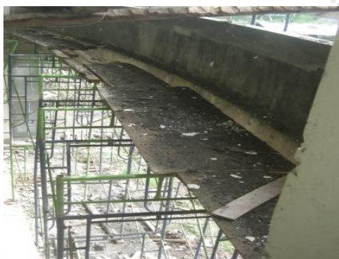
Gambar 5.23 Penggunaan scaffolding yang tidak aman (Foto 22)
