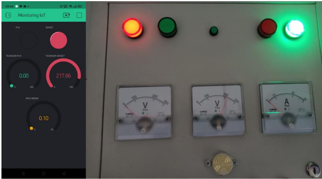
Gambar 5.11 Pengujian sistem telemonitoring IoT ketika listrik PLN dimatikan
