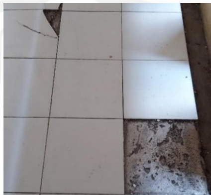
Gambar 5.12 Keramik Lantai yang Rusak
