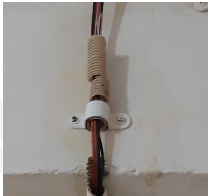
Gambar 5.26 Pipa Conduit yang Lepas
