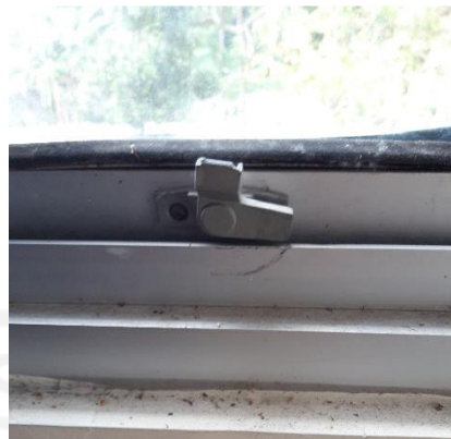
Gambar 5.14 Elemen Jendela yang Rusak
