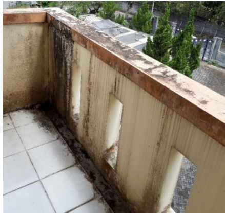
Gambar 5.11 Cat Dinding Parapet yang Rusak
