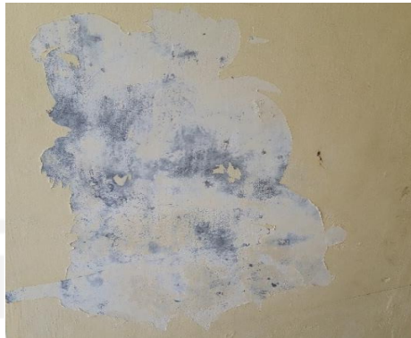
Gambar 5.9 Cat Dinding Eksterior Terkelupas
