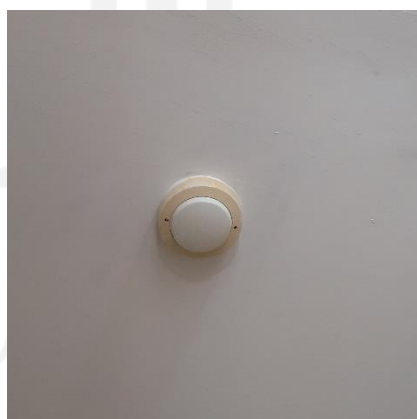
Gambar 5.28 Detektor Fire Alarm
