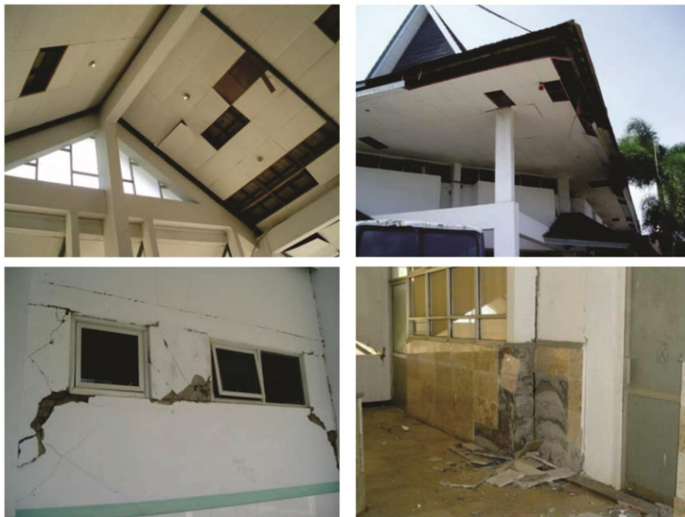
Gambar 6. Kerusakana pada non structural Rumah Sakit M. Yunus, Bengkulu
