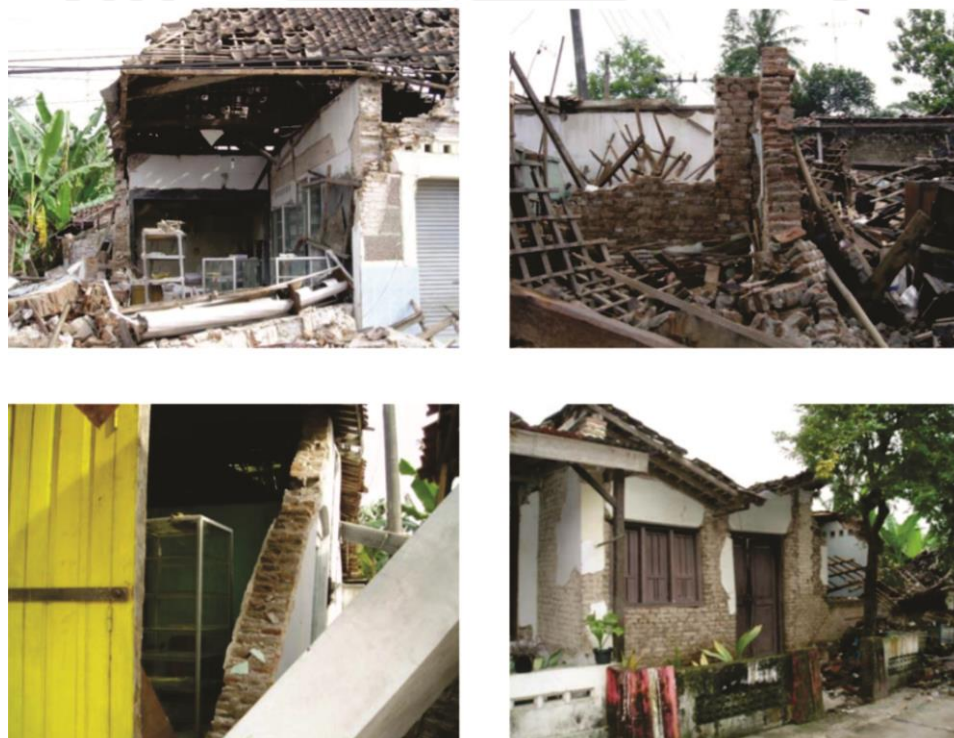
Gambar 7. Kerusakana pada non structural dan sruktural hunian warga dan bangunan komersil, Yogyakarta
