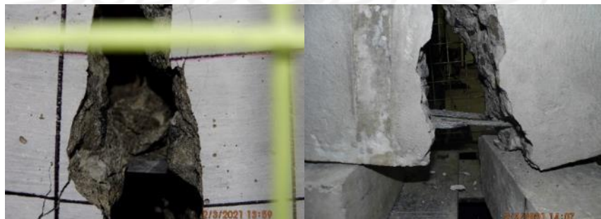
Gambar 5. 16 Detail Keruntuhan Balok Variasi I - 2
