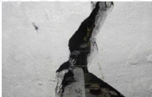
Gambar 5. 41 Kondisi CFRP Balok Variasi II - 4
