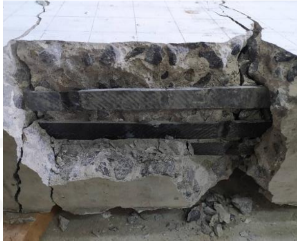
Gambar 5. 31 Kondisi BVII-1 CFRP Setelah Balok Dibongkar
