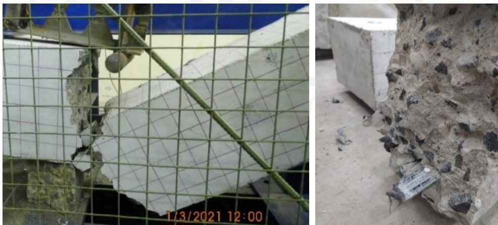
Gambar 5. 21 Detail Keruntuhan Balok Variasi I - 3
