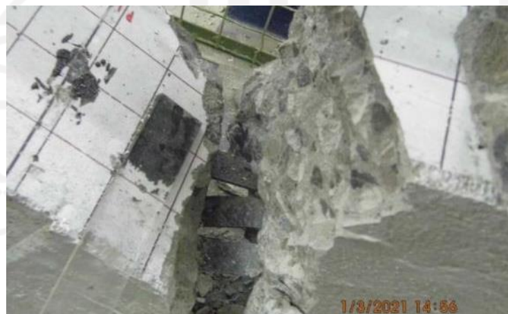
Gambar 5. 26 Detail Keruntuhan Balok Variasi I - 4
