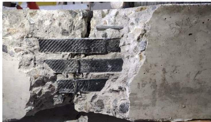
Gambar 5. 38 Kondisi BVII-1 CFRP Setelah Balok Dibongkar
