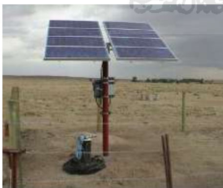
Gambar 2.22. Aplikasi Panel Surya di Permukaan Tanah
