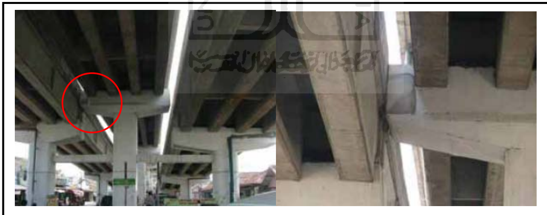
Gambar 1.12 kerusakan jembatan akibat Pounding
