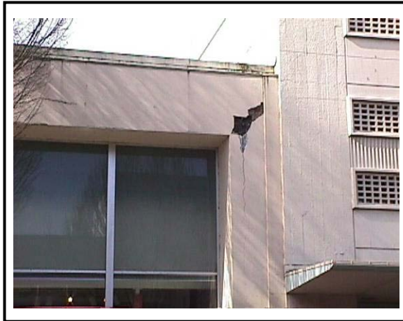
Gambar 1.7 Kerusakan pada joint balok kolom
