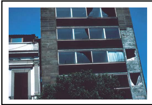
Gambar 1.9 Kerusakan akibat terjadinya Pounding ( http://libraryphoto.cr.usgs.gov/index.html )
