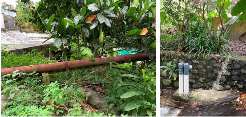
Gambar 4.30 Pipa Jaringan Effluent IPAL Komunal
