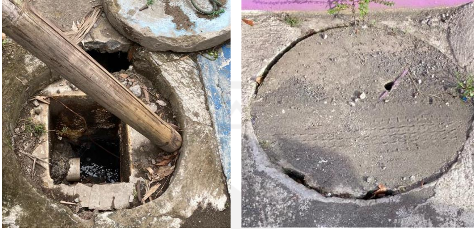
Gambar 4.28 Manhole Terbuka dan Tidak Terkunci
