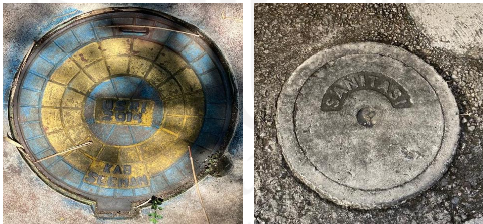
Gambar 4.29 Manhole Tertutup dan Terkunci
