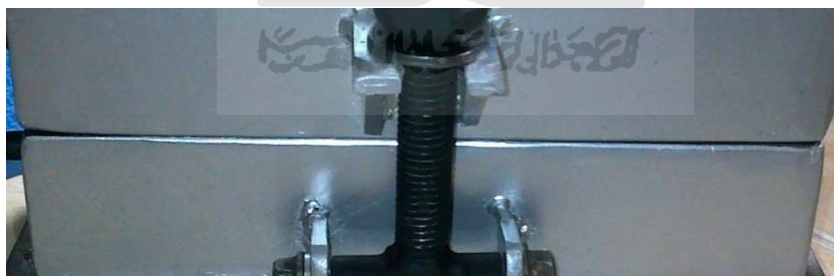
Gambar 4.30 Kebocoran pada sela-sela rangka atas dan rangka bawah
