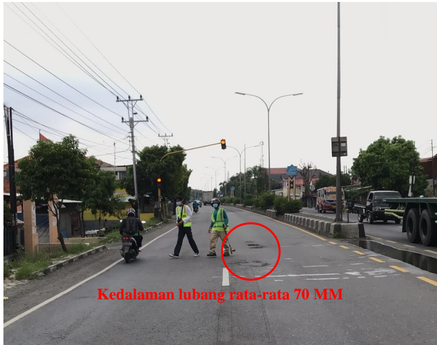
Gambar 5.2 Kondisi Jalan STA 171+300 yang Tidak Sesuai Standar Yaitu Maksimum 50 Mm
