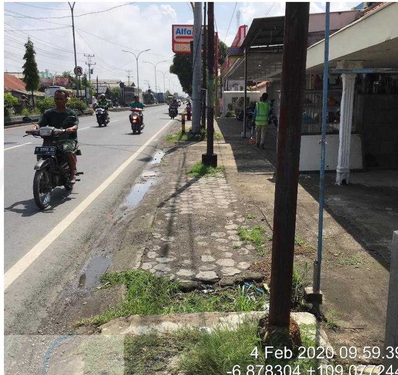
Gambar 5.7 Utilitas Tiang Listrik pada STA 170+700 – STA 172+200 Rata - Rata di Dalam Rumija Tidak Sesuai Standar Yaitu Minimum 3,4 M di Luar Rumija
