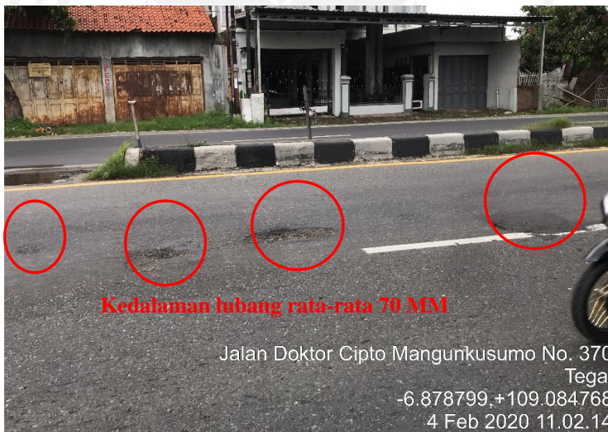
Gambar 5.3 Kondisi Jalan STA 171+400 yang Tidak Sesuai Standar Yaitu Maksimum 50 Mm
