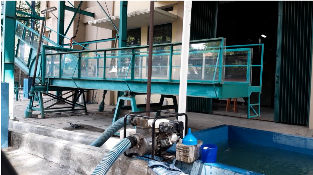
Gambar L-1.9 Pompa Pembuangan Air
