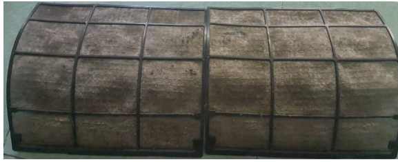
Gambar 4-8 Kondisi Filter Udara Kotor. .
