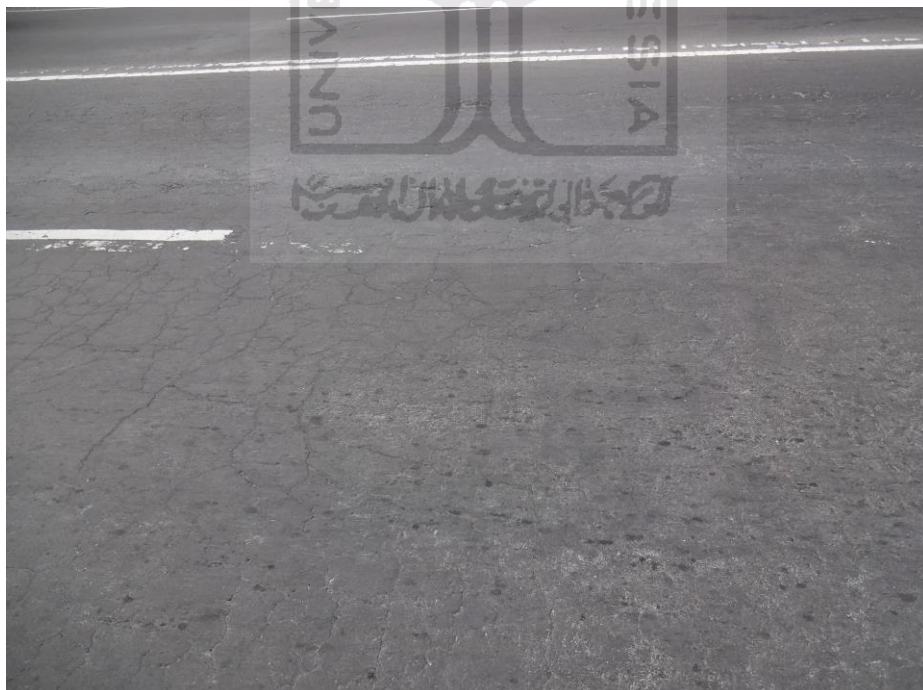
Gambar L-1.2 Kondisi Perkerasan di Jalan Yogya – Magelang Km 23 Tahun
