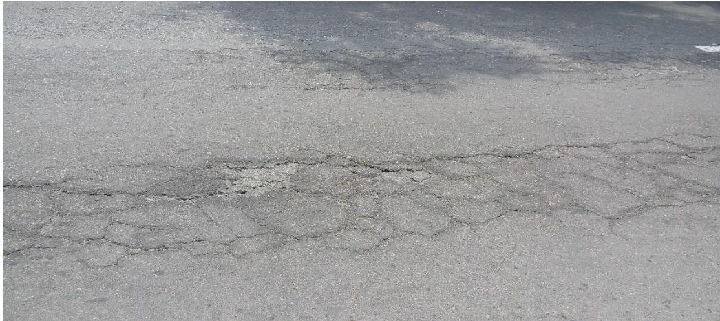
Gambar 1.1 Kerusakan Jalan Kapten Haryadi Ngebel Gede
