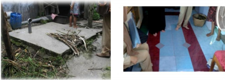
Gambar.2.11. Akses penyedotan lumpur tinja yang sulit (IUWASH & WSP 2014)
