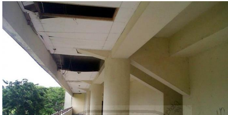
Gambar 1.2 Kondisi Plafond GOR Flobamora
