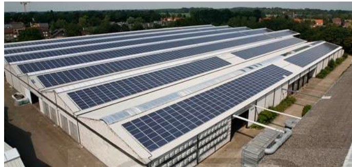
Gambar 77. Panel Surya Pada Atap Sumber : https://rantauenergi.com/
