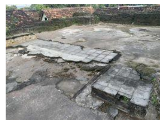
Area bangunan di sisi pojok timur yang sudah hancur tidak tersisa lagi
