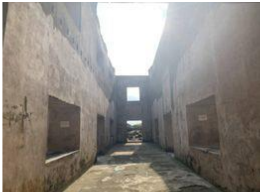
Area Bangunan di sisi barat dengan atap yang sudah hancur
