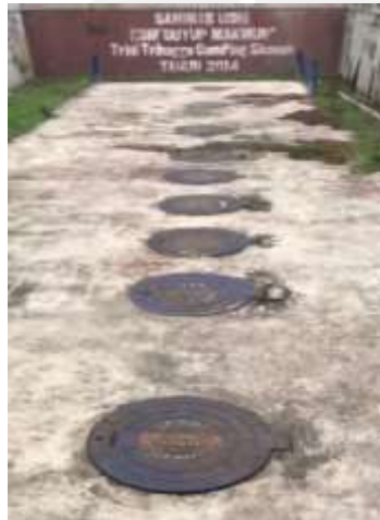
Gambar 14 Unit Pengolahan IPAL Komunal Guyup Makmur
