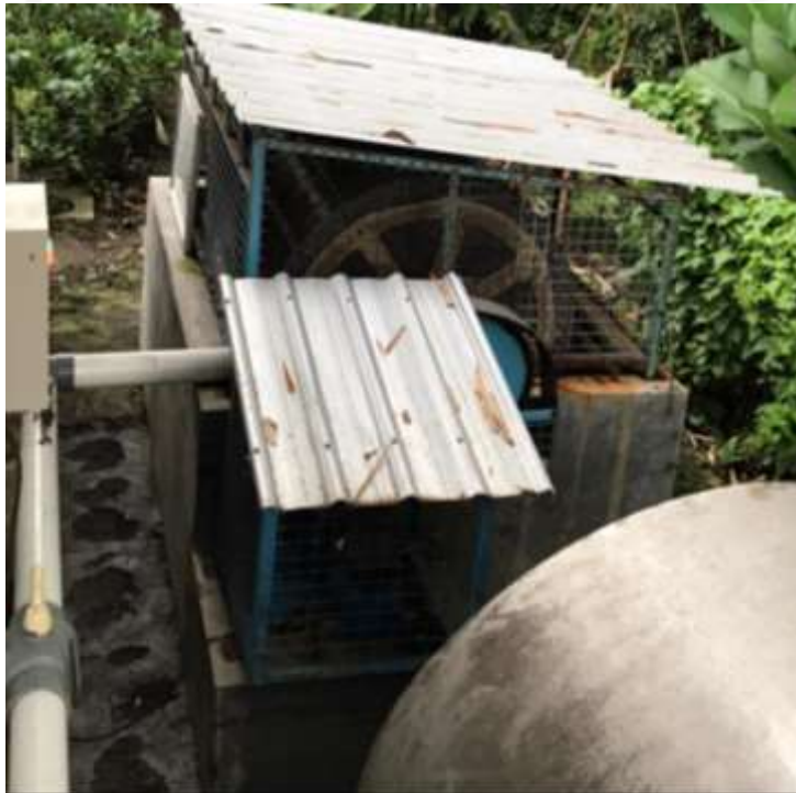
Gambar 11 Unit Pengolahan RBC IPAL Komunal Ngudi Mulyo
