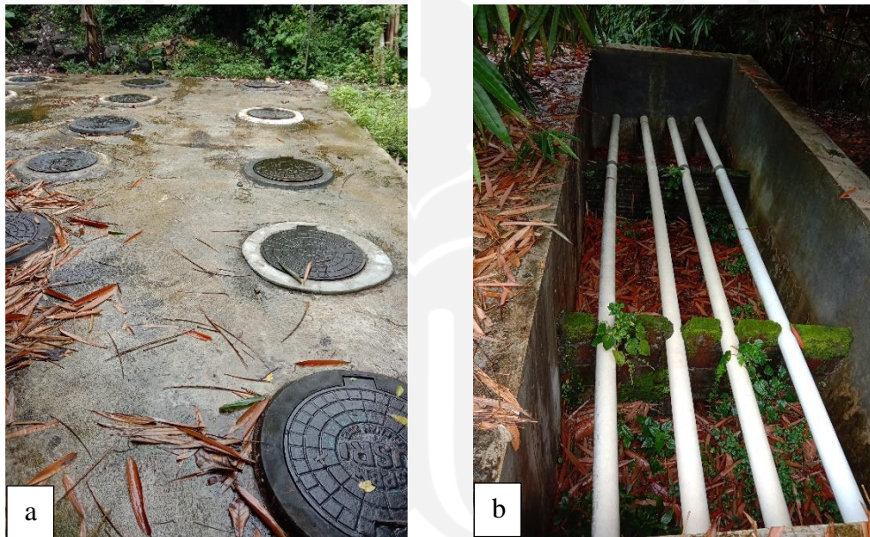
Gambar 6 (a) IPAL Palgading (b) Pipa menuju pembuangan
