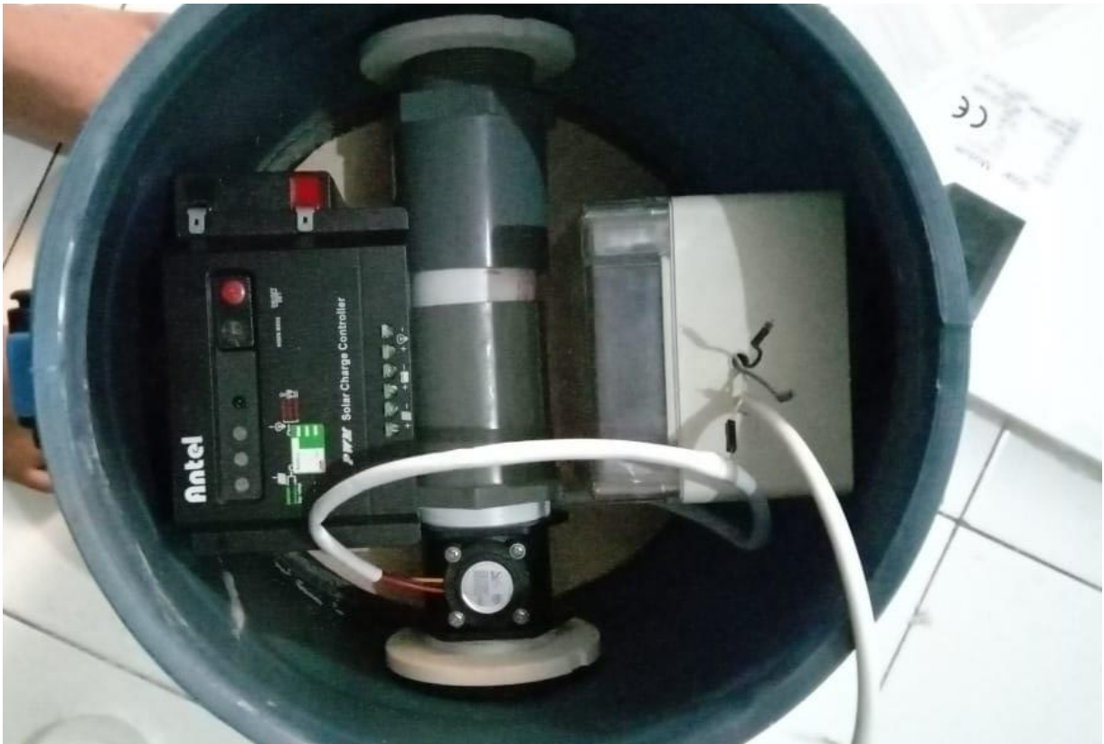
Penempatan Sensor, Mikrokontroler dan Baterai
