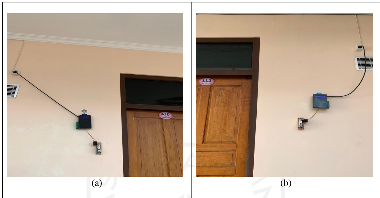
Gambar 5.1.1. (a) Pemasangan alat pada MCB kamar 1, (b) Pemasangan alat pada MCB kamar 2
