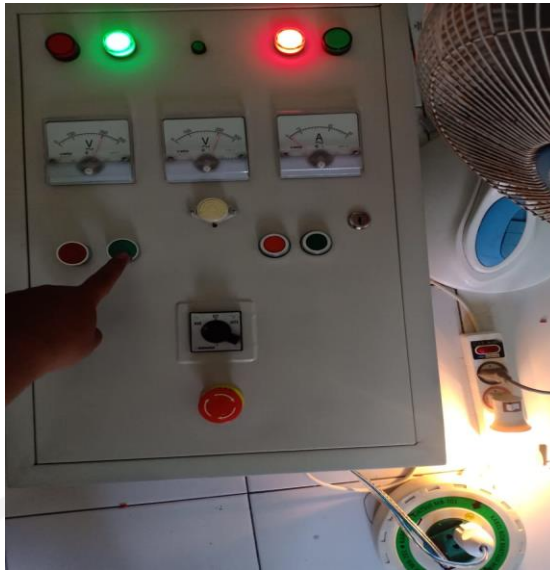
Gambar 5.2 Pengujian switching manual dengan PLN sebagai sumber listrik
