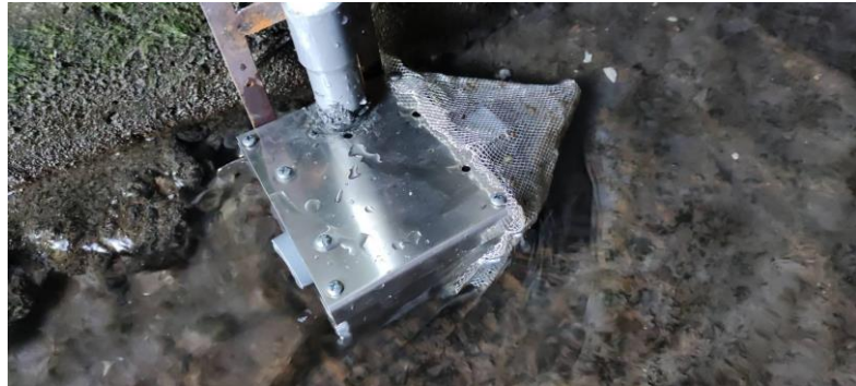
Gambar 4.1. Perbaikan Sensor waterflow
