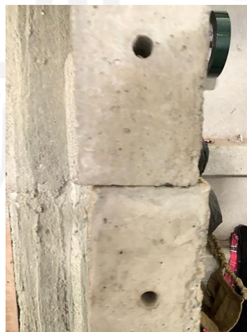
Gambar 5.3 Struktur RISHA yang Kurang Presisi
