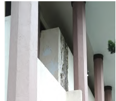
Gambar 1.3 Rembes Air Dari Plafond, Lantai Yang Rusak, dan Lapisan Dinding Rusak Sumber : Penulis, 2020
