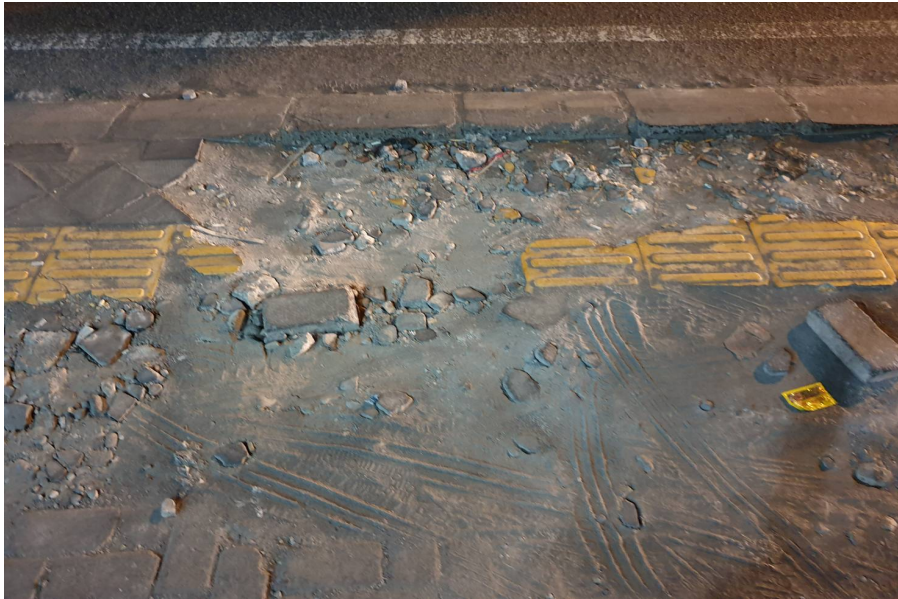
Gambar kondisi Guiding Block yang rusak di daerah Seturan Babarsari pada hari kamis tanggal 27 Februari 2020 pukul 20.55
