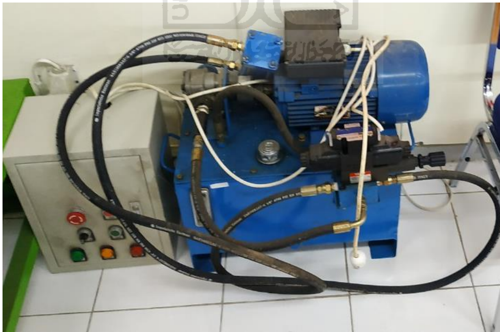
Gambar 4- 9 Controll box dan pompa oli.
