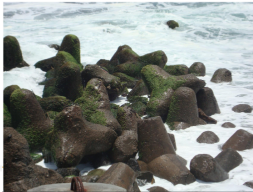
Gambar 2.1 Terjadi abrasi pada tetrapod bangunan jetty dengan mutu beton K-400 Sumber : PSIT-UGM, 2013
