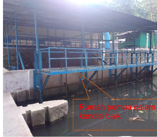
Rumah pompa di daerah tengah Sungai Winongo
