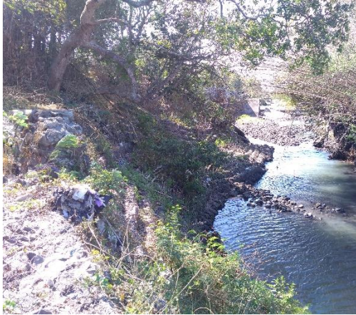
Kondisi bronjong di hilir Sungai Winongo
