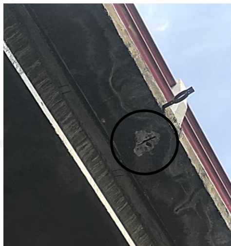
Gambar 5.48 Selimut Beton yang Mengelupas Sehingga Terlihat Tulangan Pada Pelat Lantai Bentang Pertama Jembatan Bogem C
