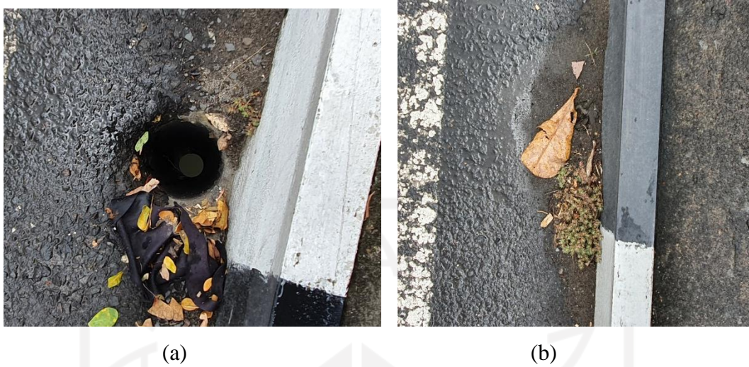
Gambar 5.51 Contoh Pipa Cucuran Pada Bentang 2 Jembatan Bogem C
