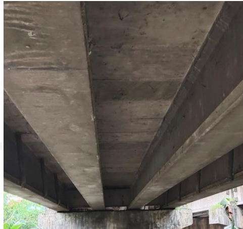
Gambar 5.11 Kondisi Pelat Lantai Bentang Ketiga Jembatan Bogem A
