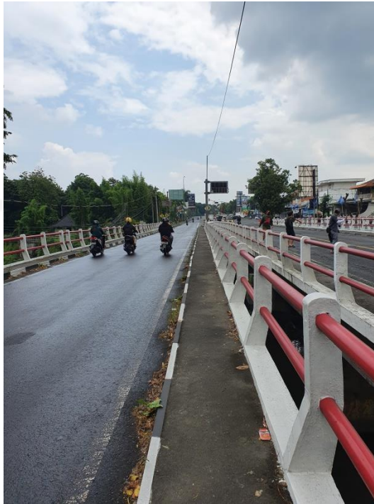
Gambar 5.49 Kondisi Permukaan Aspal Jembatan Bogem C
