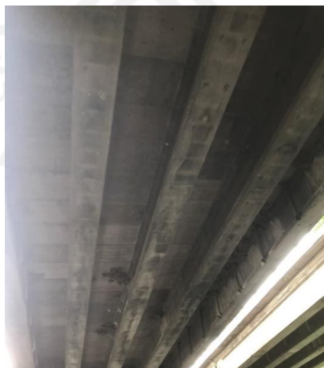
Gambar 5.28 Kondisi Pelat Lantai Bentang Kedua Jembatan Bogem B
