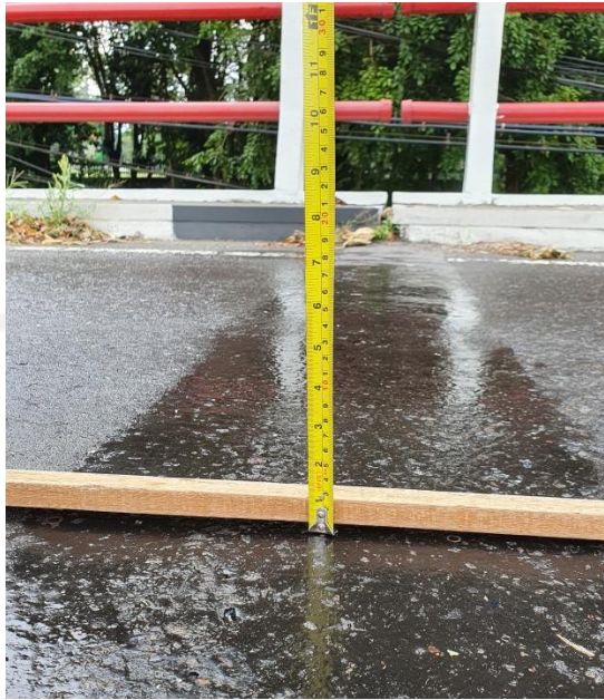
Gambar 5.54 Perbedaan Tinggi Expansion Joint 2 Jembatan Bogem C
