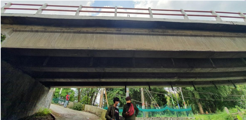
Gambar 5.45 Kondisi Gelagar Bentang Pertama Jembatan Bogem C
