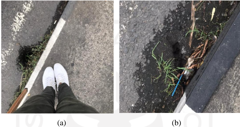
Gambar 5.14 Contoh Pipa Cucuran Pada Bentang 2 Jembatan Bogem A
