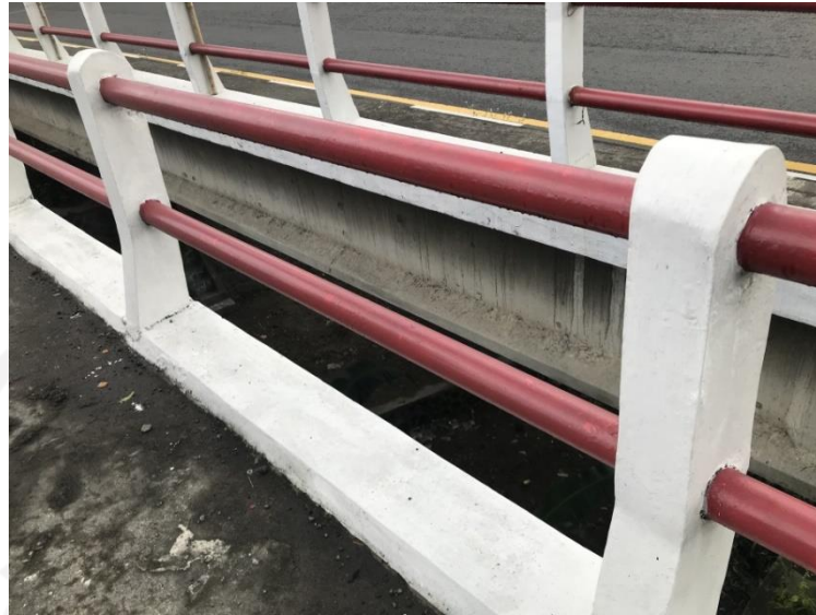
Gambar 5.40 Kondisi Tiang Sandaran Pada Bentang Ketiga Jembatan Bogem B
