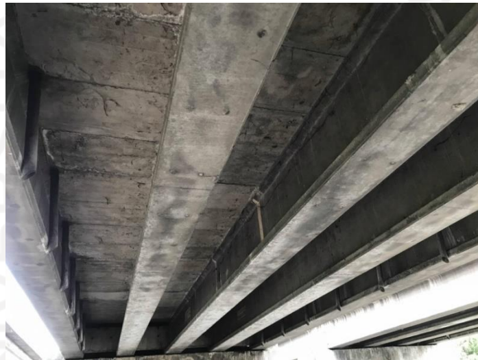
Gambar 5.27 Kondisi Pelat Lantai Bentang Pertama Jembatan Bogem B
