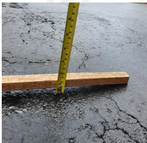
Gambar 5.56 Perbedaan Tinggi Expansion Joint 4 Jembatan Bogem C
