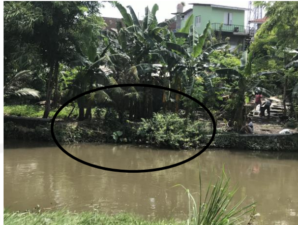
Gambar 5.59 Talud Runtuh di Sisi Timur Jembatan
