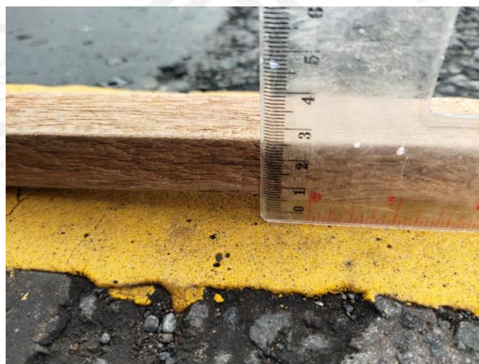
Gambar 5.19 Perbedaan Tinggi Pada Expansion Joint 4 Jembatan Bogem A
