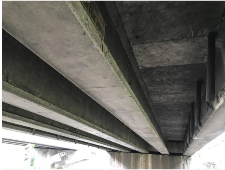
Gambar 5.29 Kondisi Pelat Lantai Bentang Ketiga Jembatan Bogem B
