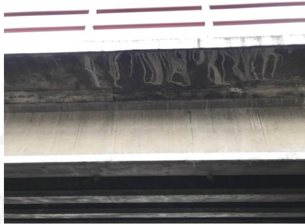
Gambar 5.24 Kondisi Gelagar Bentang Pertama Jembatan Bogem B
