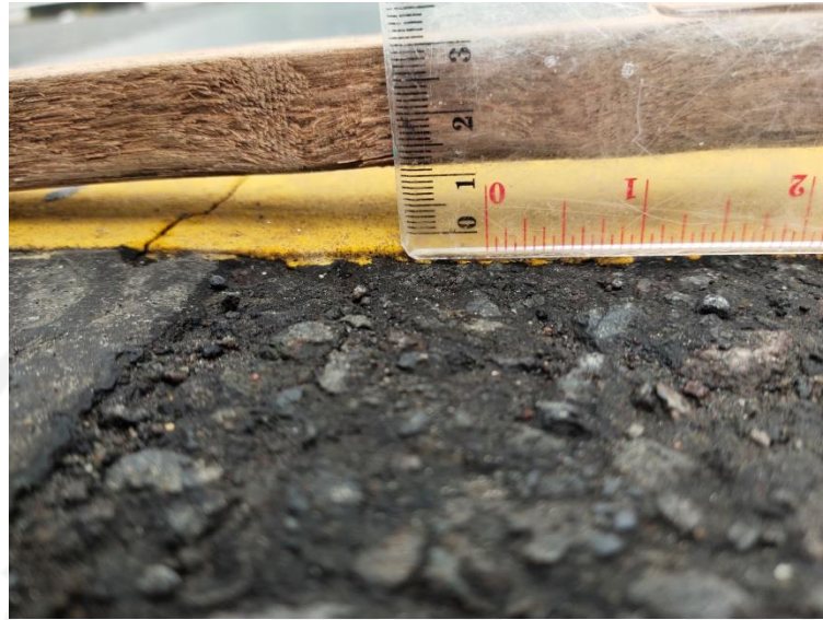
Gambar 5.18 Perbedaan Tinggi Pada Expansion Joint 3 Jembatan Bogem A
