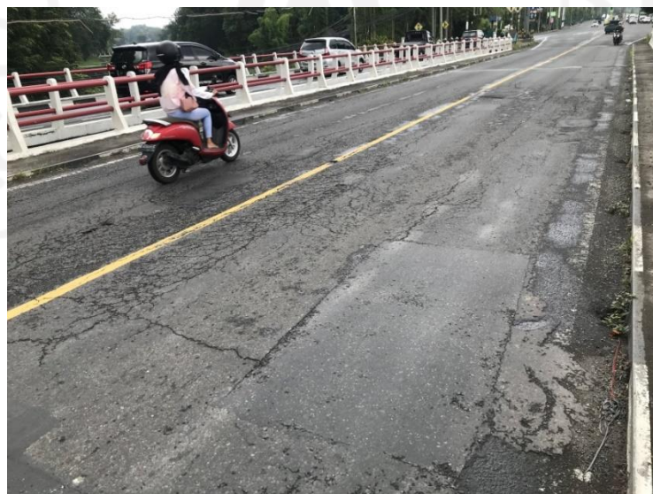
Gambar 5.30 Cracking Pada Permukaan Aspal Jembatan Bogem B
