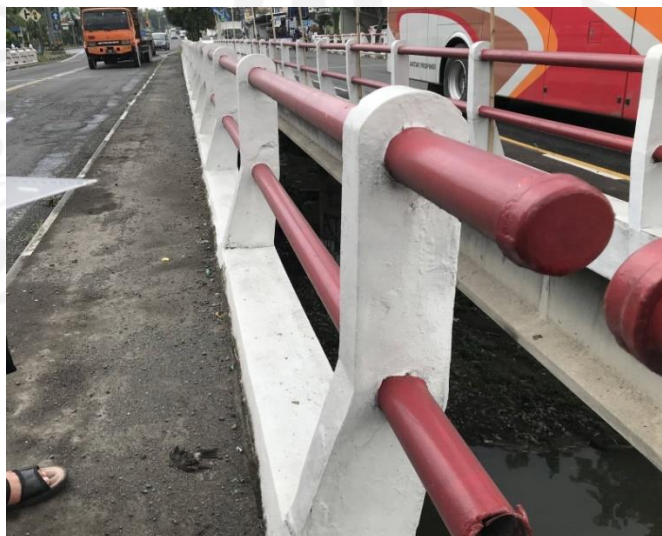
Gambar 5.39 Kondisi Tiang Sandaran Pada Bentang Kedua Jembatan Bogem B
