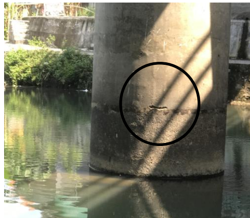
Gambar 5.4 Selimut Beton yang Mengelupas Sehingga Terlihat Tulangan Pada Pilar 1 Jembatan Bogem A
