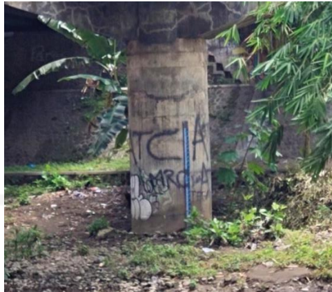
Gambar 5.5 Kondisi Pilar 2 Jembatan Bogem A
