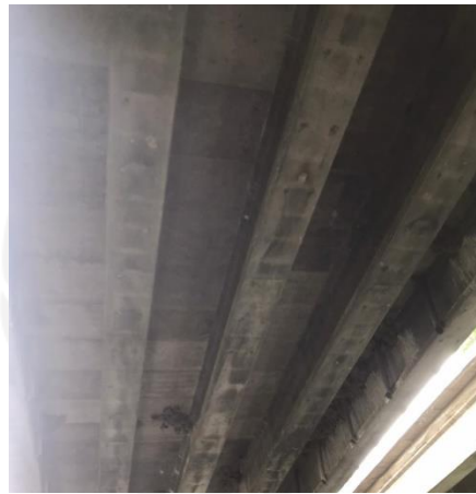
Gambar 5.10 Kondisi Pelat Lantai Bentang Kedua Jembatan Bogem A
