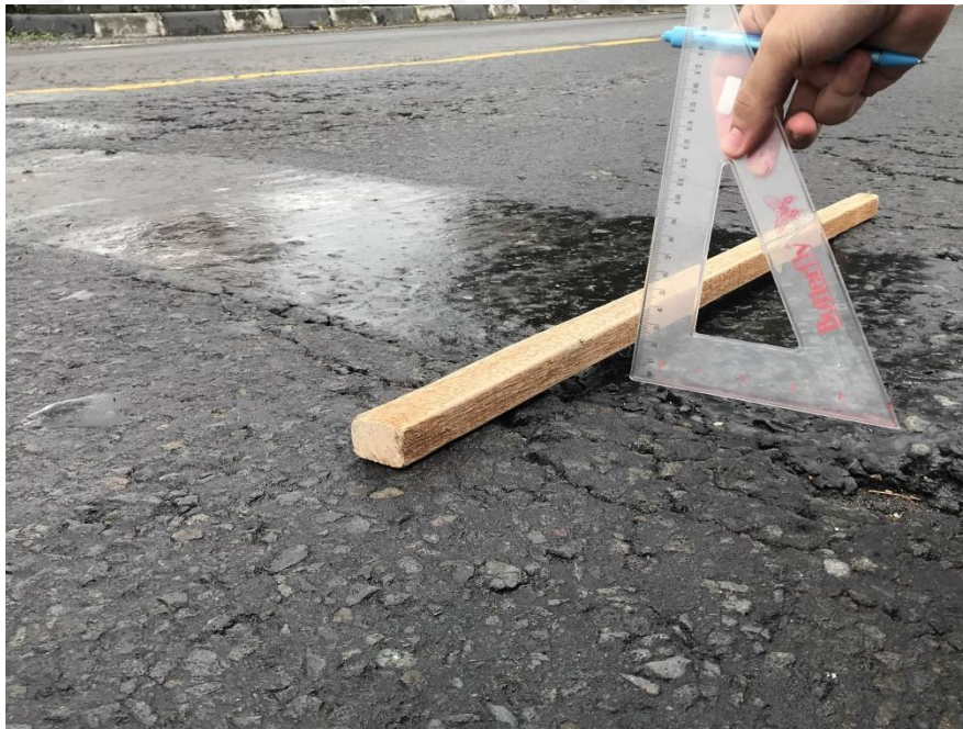
Gambar 5.35 Perbedaan Tinggi Expansion Joint 2 Jembatan Bogem B
