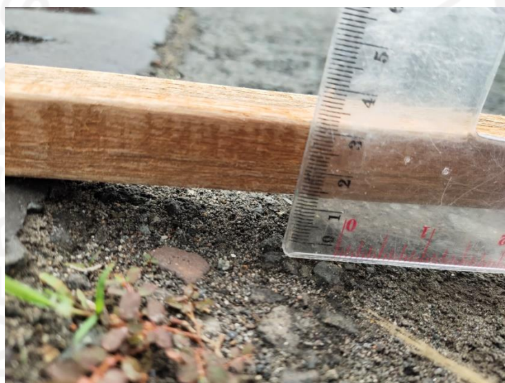
Gambar 5.17 Perbedaan Tinggi Pada Expansion Joint 2 Jembatan Bogem A
