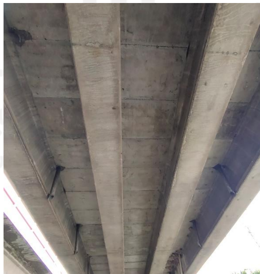
Gambar 5.9 Kondisi Pelat Lantai Bentang Pertama Jembatan Bogem A
