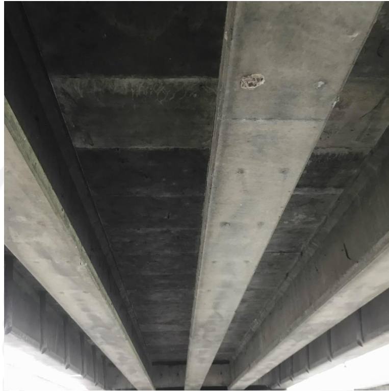
Gambar 5.47 Kondisi Gelagar Bentang Ketiga Jembatan Bogem C
