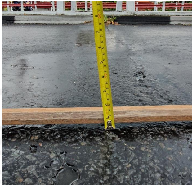
Gambar 5.55 Perbedaan Tinggi Expansion Joint 3 Jembatan Bogem C
