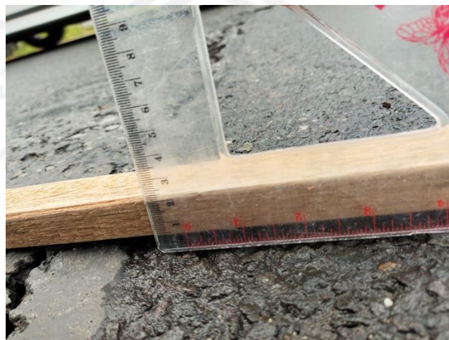
Gambar 5.16 Perbedaan Tinggi Pada Expansion Joint 1 Jembatan Bogem A
