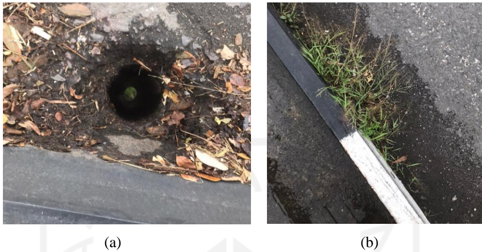
Gambar 5.15 Contoh Pipa Cucuran Pada Bentang 3 Jembatan Bogem A (a) Pipa Cucuran Tidak Tersumbat (b) Pipa Cucuran Tersumbat
