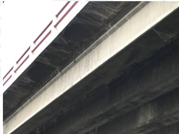
Gambar 5.25 Kondisi Gelagar Bentang Kedua Jembatan Bogem B
