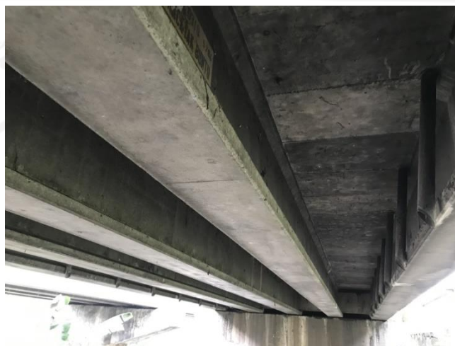
Gambar 5.26 Kondisi Gelagar Bentang Ketiga Jembatan Bogem B
