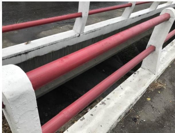
Gambar 5.38 Kondisi Tiang Sandaran Pada Bentang Pertama Jembatan Bogem B
