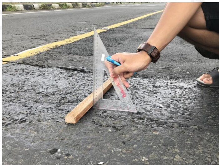
Gambar 5.37 Perbedaan Tinggi Expansion Joint 4 Jembatan Bogem B
