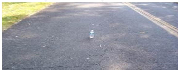
Gambar 3.15 Low Severity Level pada Retak Blok ( Block Cracking )
