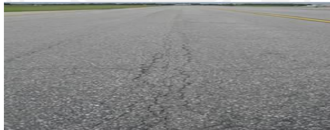
Gambar 3.2 Low Severity Level pada Retak Kulit Buaya ( Alligator Cracking )
