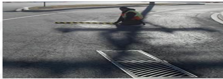
Gambar 3.26 High Severity Level pada Amblas ( Depression )
