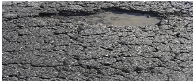
Gambar 3.29 Medium Severity Level pada Lubang ( Potholes )
