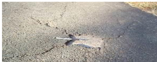
Gambar 3.28 Low Severity Level pada Lubang ( Potholes )
