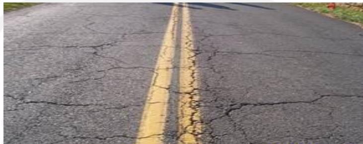
Gambar 3.17 High Severity Level pada Retak Blok ( Block Cracking )
