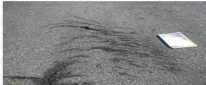
Gambar 3.11 Low Severity Level pada Retak Slip ( Shrinkage Crack )
