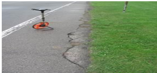
Gambar 3.5 Low Severity Level pada Retak Pinggir ( Edge Crack )
