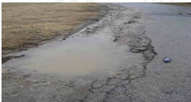
Gambar 3.7 High Severity Level pada Retak Pinggir ( Edge Crack )
