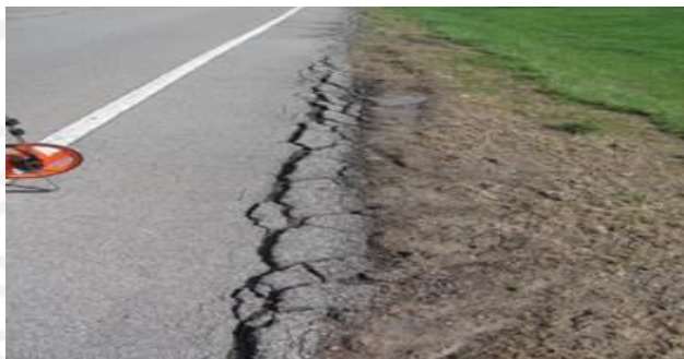
Gambar 3.6 Medium Severity Level pada Retak Pinggir ( Edge Crack )
