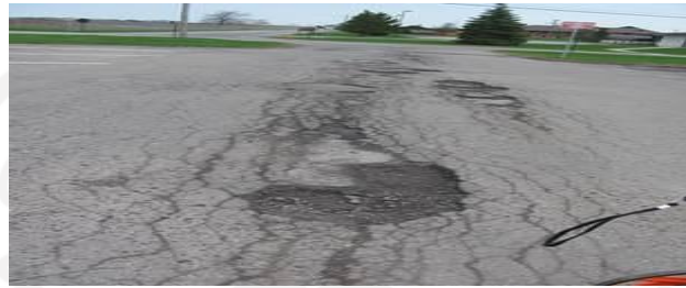
Gambar 3.30 High Severity Level pada Lubang ( Potholes )
