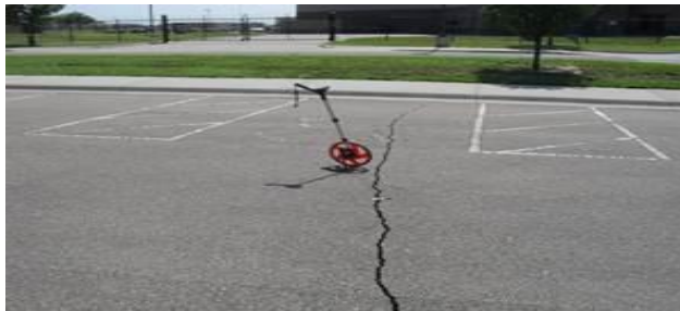
Gambar 3.9 Medium Severity Level pada Retak Memanjang
