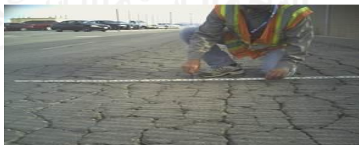
Gambar 3.19 Medium Severity Level pada Alur ( Rutting )
