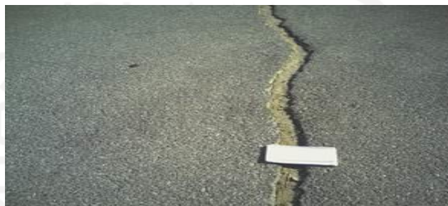
Gambar 3.10 High Severity Level pada Retak Memanjang
