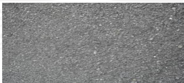
Gambar 3.31 Low Severity Level pada Pelepasan Butiran ( Ravelling )
