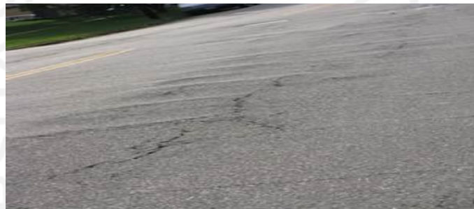
Gambar 3.22 Medium Severity Level pada Keriting ( Corrugation )
