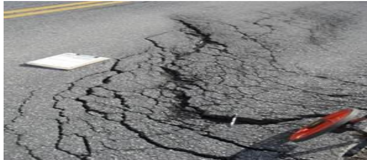
Gambar 3.13 High Severity Level pada Retak Slip ( Shrinkage Crack )
