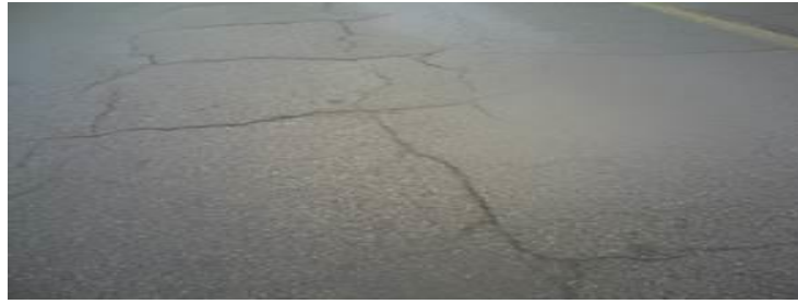
Gambar 3.16 Medium Severity Level pada Retak Blok ( Block Cracking )
