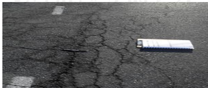
Gambar 3.3 Medium Severity Level pada Retak Kulit Buaya ( Alligator Cracking )
