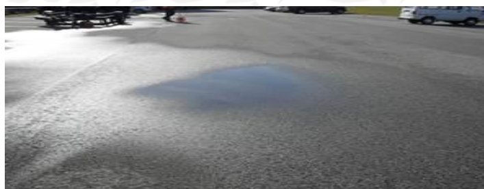
Gambar 3.24 Low Severity Level pada Amblas ( Depression )
