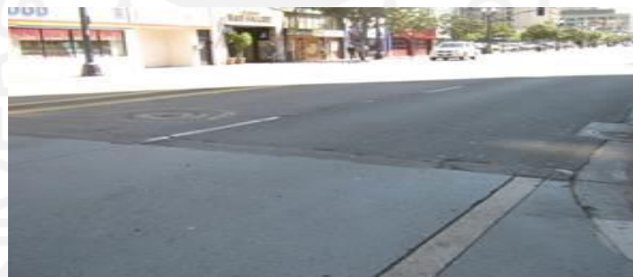
Gambar 3.18 Low Severity Level pada Alur ( Rutting )
