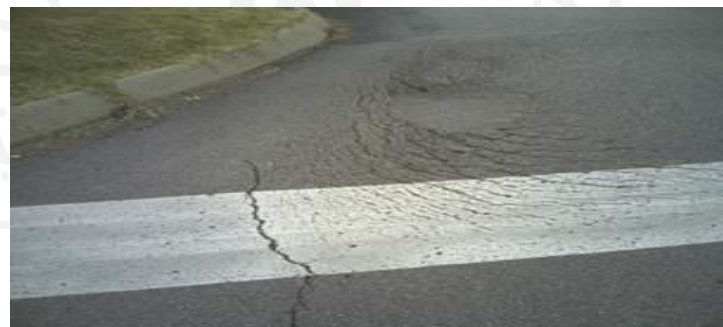
Gambar 3.12 Medium Severity Level pada Retak Slip ( Shrinkage Crack )
