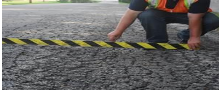
Gambar 3.20 High Severity Level pada Alur ( Rutting )
