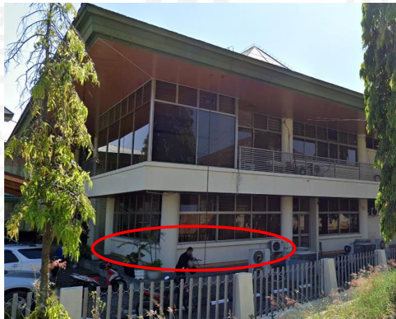
Gambar 5.15 Pemasangan dinding pada jendela menyebabkan short column
