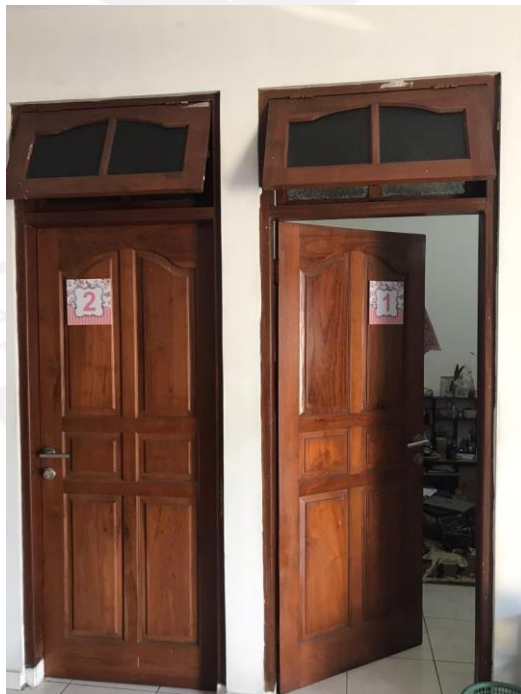
Gambar 5 ventilasi yang ada di depan kamar
