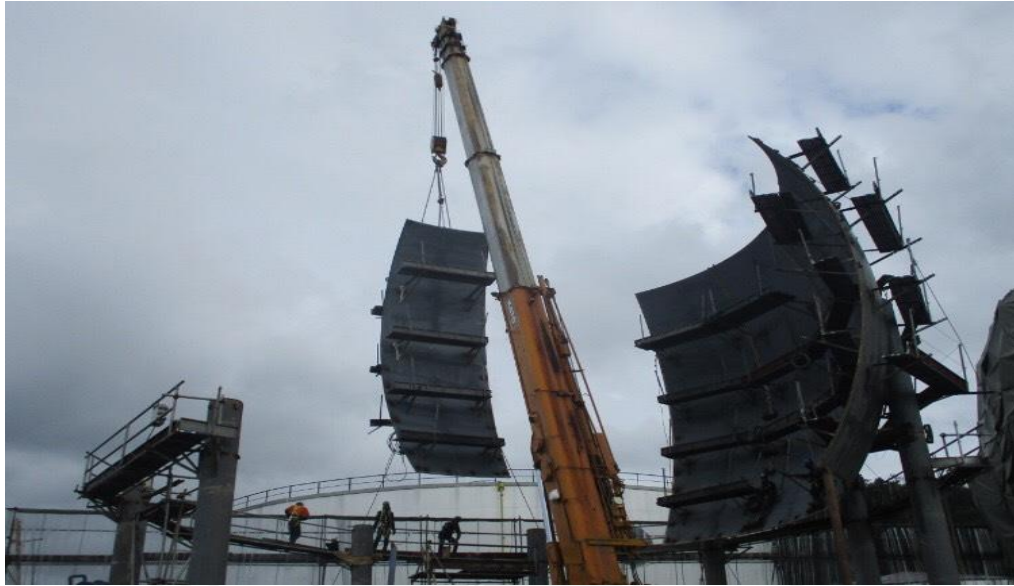
Gambar L-3.1 Pekerjaan pemasangan equator shell tangki Pada proyek pembangunan Terminal LPG Pressurized Wayame Ambon
