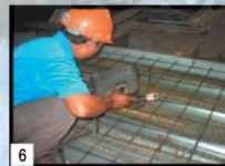
6 Kakukan Union Floor Deck W-1000® pada bagian tepi dengan las titik di balok baja Fix Union Floor Deck W-1000® on the edge form with spot welding to the beam
