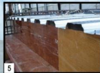
5 Kakukan Union Floor Deck W-1000® dengan paku pada bekisting Fix Union Floor Deck W-1000® with nail on formwork
