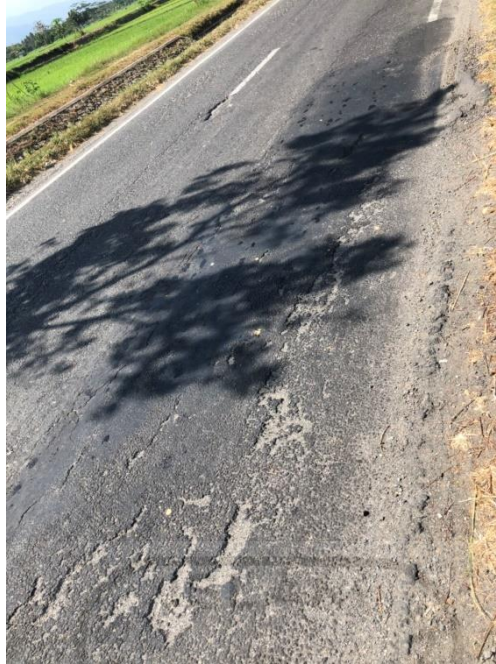
Gambar 1.2 Kerusakan Permukaan Jalan Berupa Lubang
