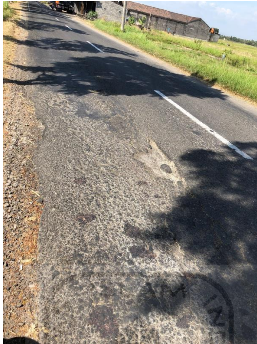
Gambar 1.4 Kerusakan Jalan Berupa Retak ( Cracking )
