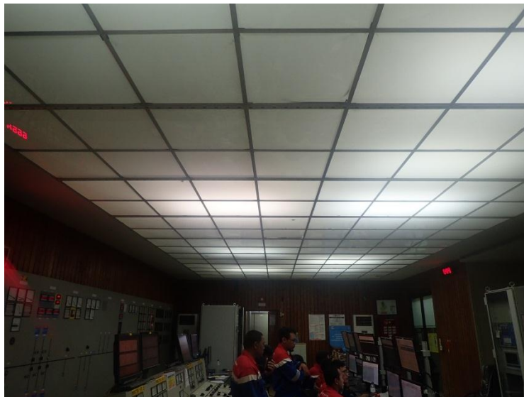
Gambar 4. 6 Control Room Power Plant sebelum perbaikan
