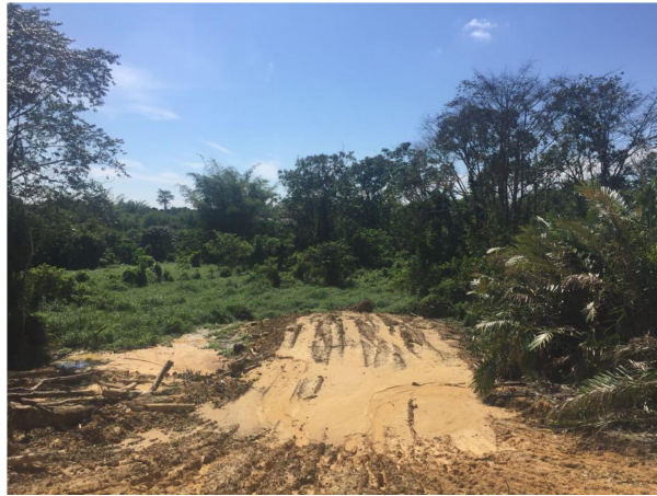
Gambar 1.1 Kondisi tanah pada STA 1+175 sampai STA 2+150
