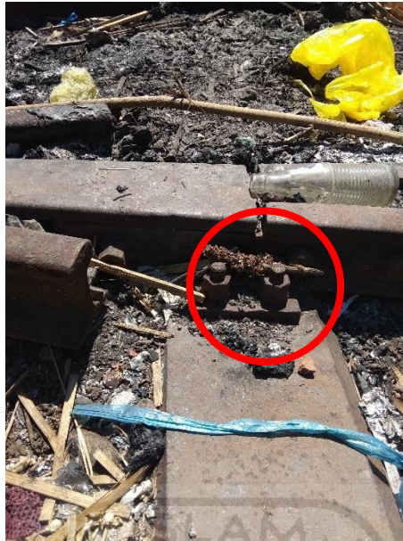
Gambar 5.15 Dokumentasi Pengamatan Penambat
