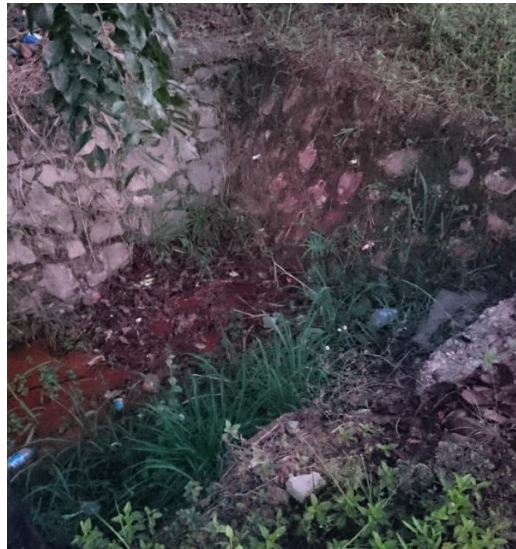
Gambar 5.7 Kondisi Saluran Nomor 22
