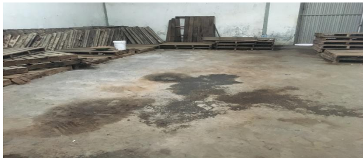
Gambar 4.4 Air Yang Masuk ke Gudang Karena Atap Gudang Yang Bocor
