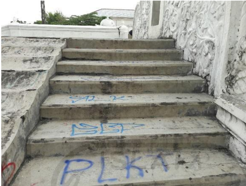
Dokumentasi vandalisme di Plengkung Gading atau Plengkung Nirbaya, diambil pada tanggal 26 Oktober 2016 pada pukul 14.00 WIB
