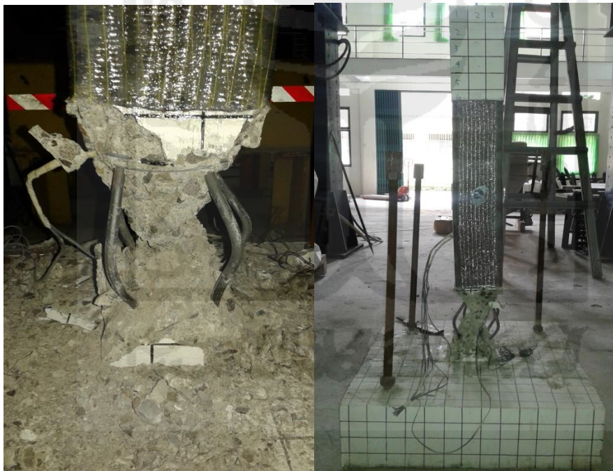
28. Pola kerusakan kolom GFRP-2 (KG2)
