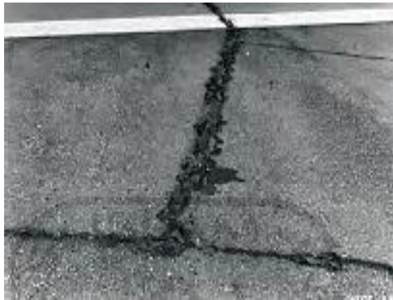
Gambar 3.6 Retak Reflektif Sambungan ( Joint Reflection Cracking ) (Sumber : Bahlawant, 2011)
