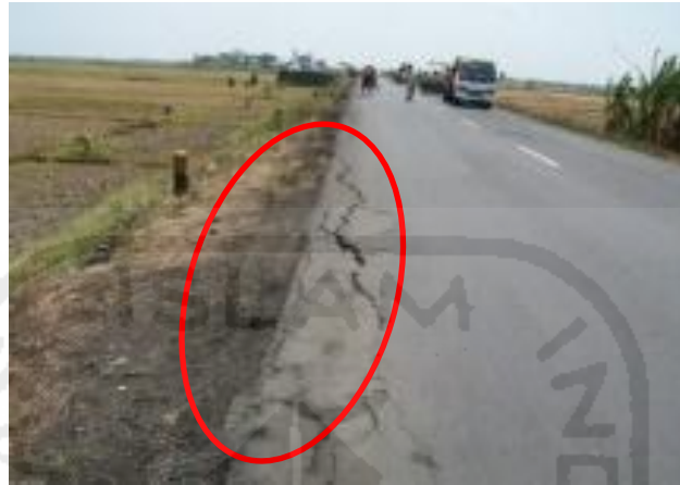
Gambar 3.15 Retak Pinggir ( Edge Crack ) (Sumber : Bahlawant, 2011)
