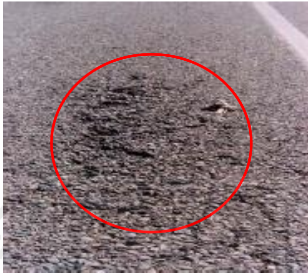
Gambar 3.13 Pelepasan Butiran ( Weathering/Raveling ) (Sumber : Hafid, 2013)
