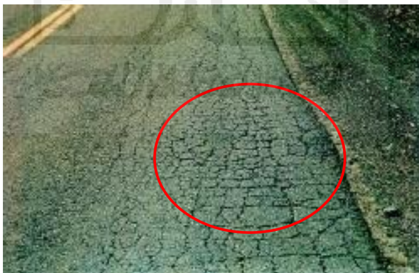
Gambar 3.1 Retak Kulit Buaya ( Alligator Cracking ) (Sumber : Hafid, 2013)
