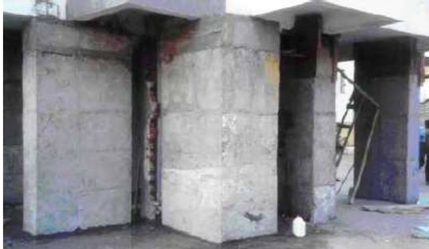
Gambar 3.33 Jacketing yang kurang tepat, jacketing kolom menyebabkan dimensi kolom sangat besar (Murty et al , 2009)
