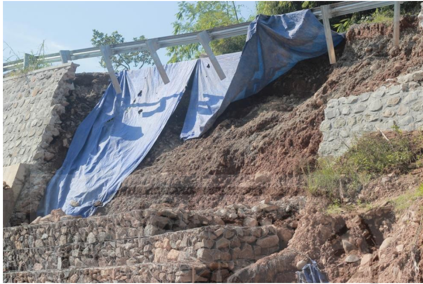
Gambar 5.1 Kondisi Lereng saat Longsor
