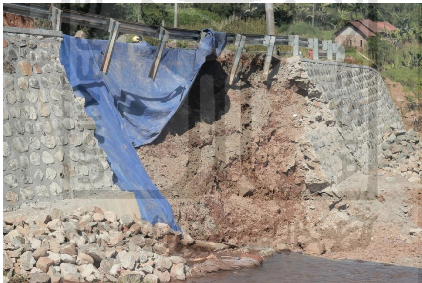
Gambar 5.2 Kondisi Lereng saat Longsor
