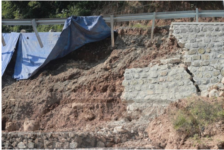
Gambar 5.11 Kondisi Lereng Saat Terjadi Longsor
