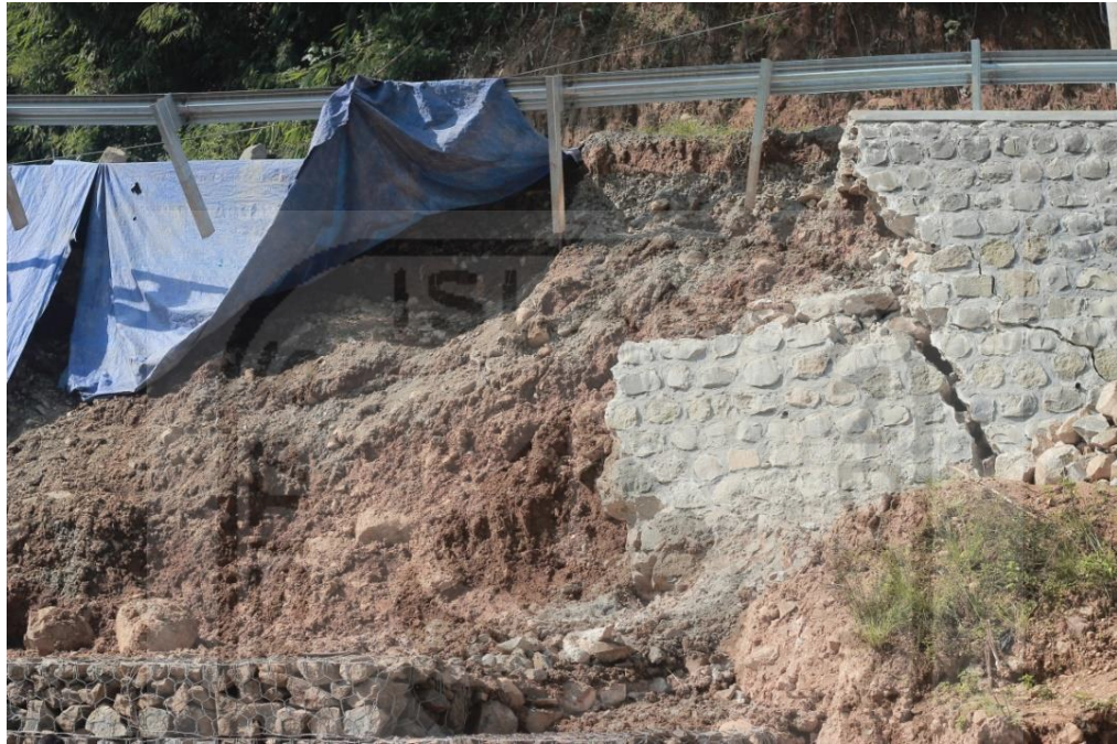
Gambar 1.1 Lokasi Longsor, Jalan Banjarnegara-Wanayasa Kilometer 70,5
