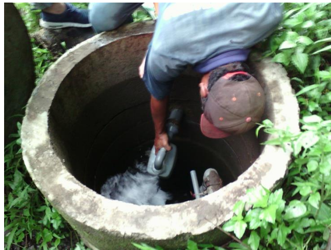
Gambar 7.2 Pengukuran Debit Untuk Pengembangan Jaringan
