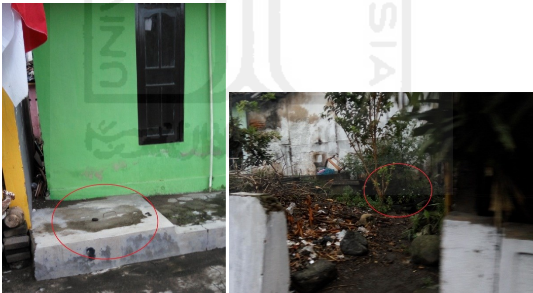
Gambar 4.1 Kondisi tangki septik di luar rumah yang jauh dari bantaran sungai
