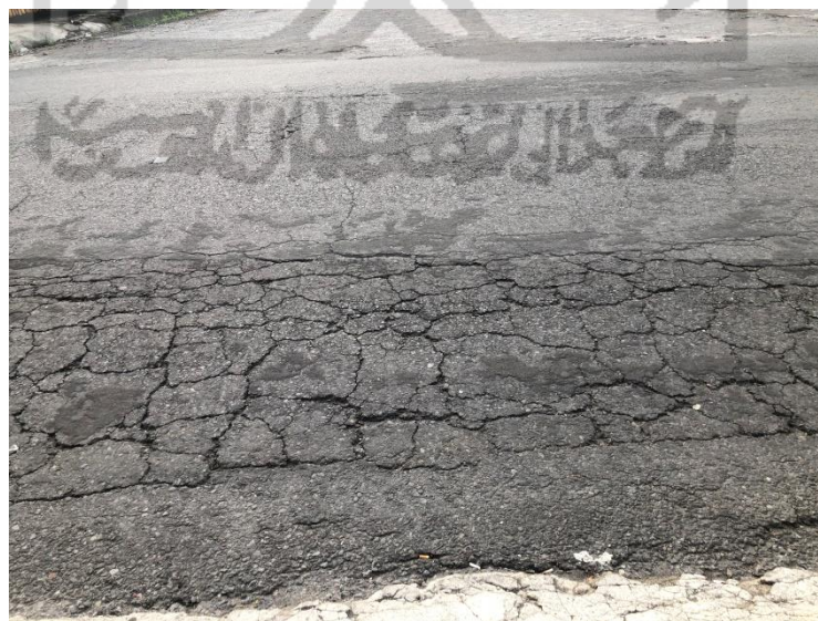
Gambar 1. 2 Kerusakan Retak Kulit Buaya pada Sta.13+350
